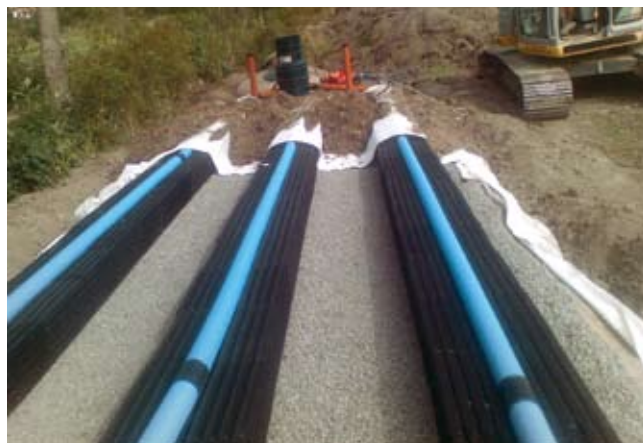
Sandfiltergrøft med BioModuler.
